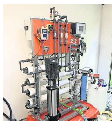
Diese Anlage soll Nitrat aus dem Trinkwasser entfernen.
