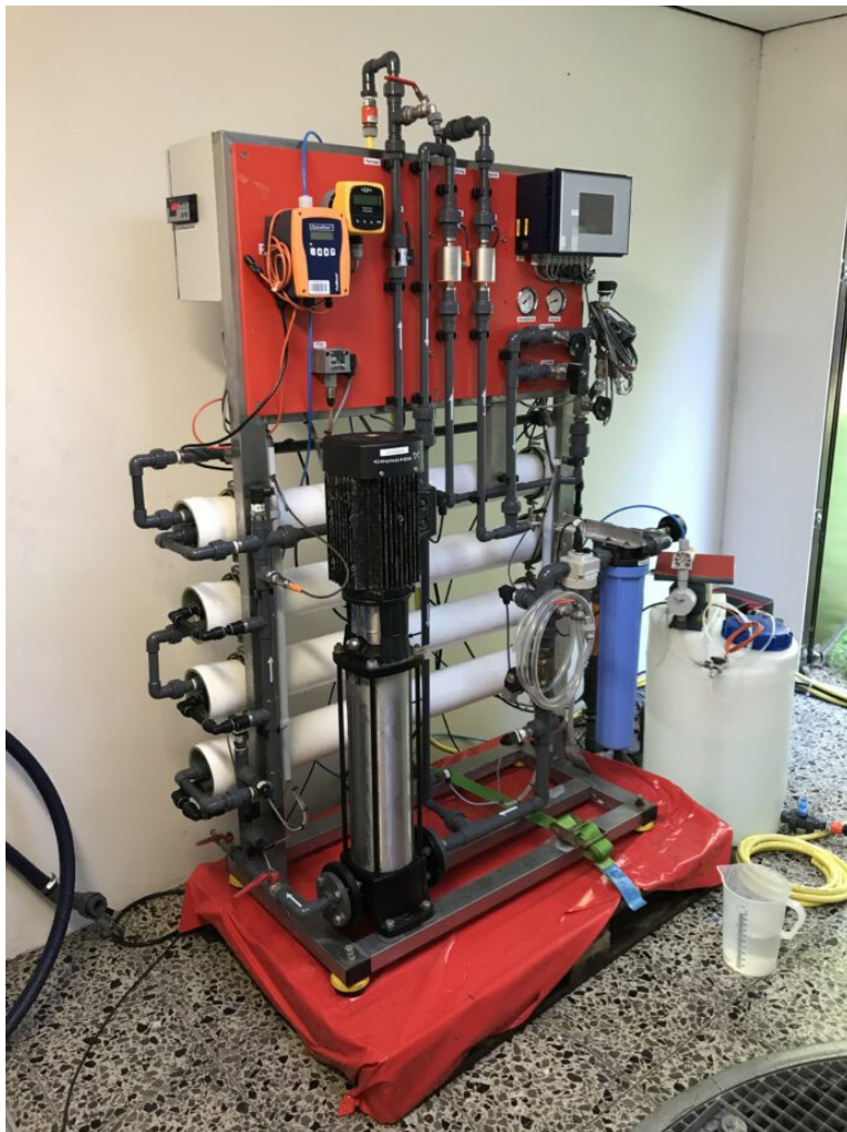
Die Pilotanlage im Wasserwerk Hagen. / Foto: Wasserverband Garbsen-Neustadt
