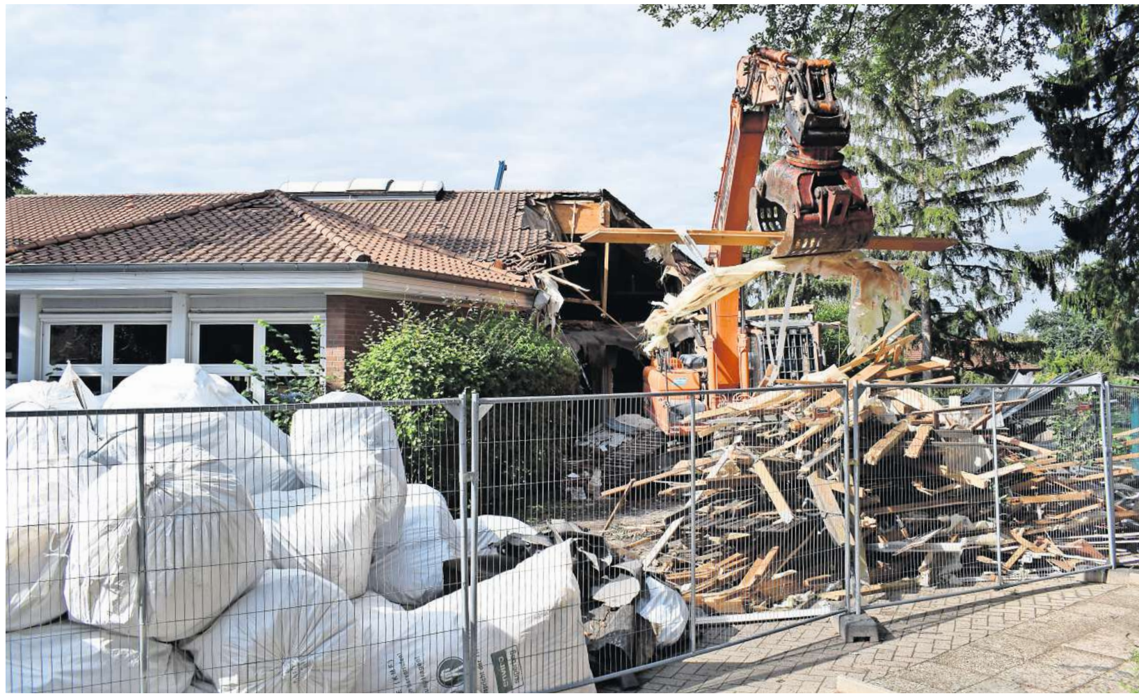
Nach nur wenigen Stunden hat ein Bagger schon große Teile des Dachstuhls der Pavillonbauten an der Grundschule Stelingen abgetragen. FOTOS: JUTTA GRÄTZ
