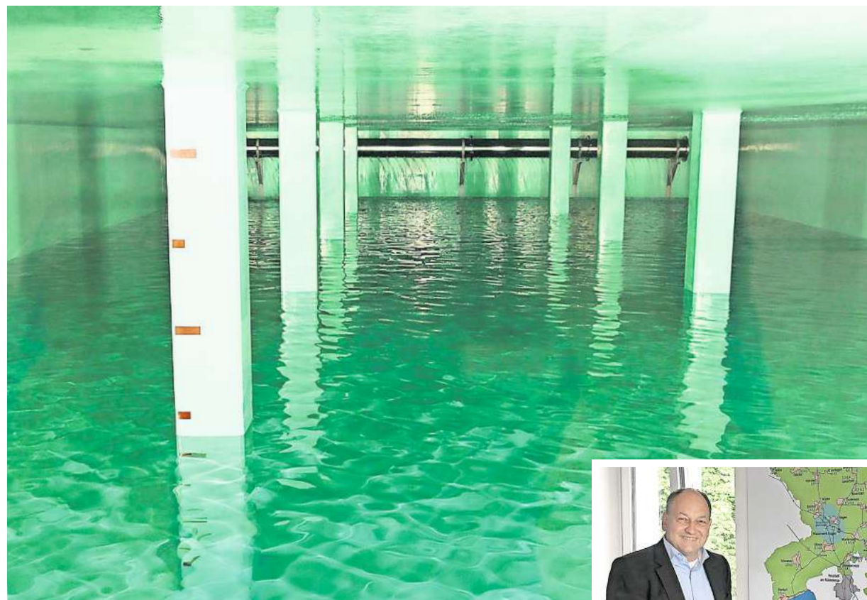
Abgaben von mehr als 20.000 Kubikmeter am Tag: Die Speicher des Wasserverbands Garbsen-Neustadt – wie hier im Wasserwerk Hagen – leeren sich derzeit schnell.
