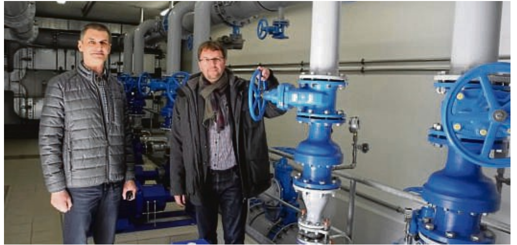
Geschäftsführer Stephan Schumüller (rechts) und Marcus Möser (Leiter Wassergewinnung) erklären die Funktion der Pumpenanlage im Wasserwerk Hagen. Fotos: Stache
