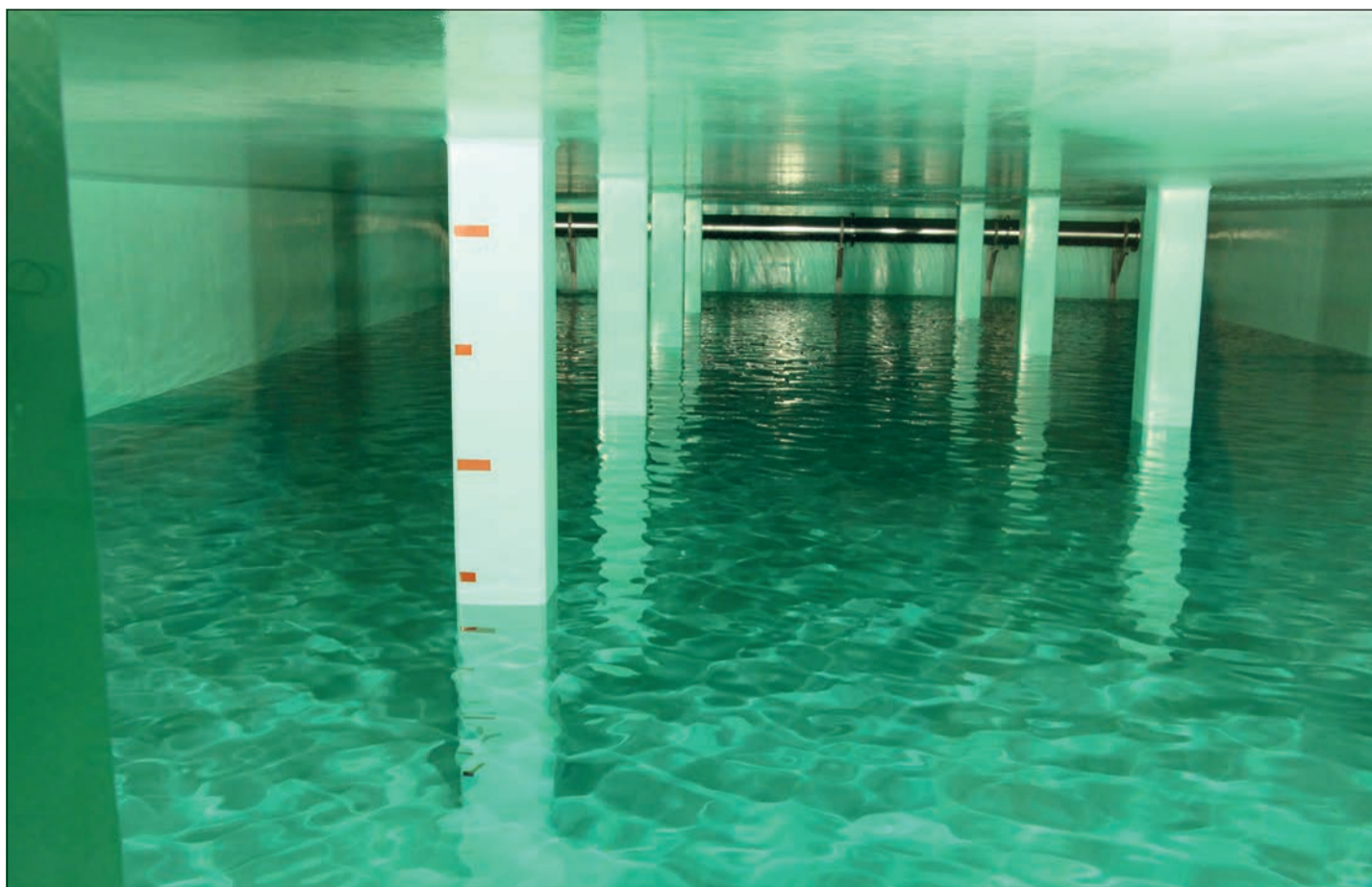
Durch die hohe Wasserentnahme wird das Füllen der Trinkwasserbehälter für den Wasserverband immer schwieriger.
