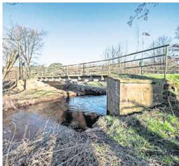
Die alte Wirtschaftswegbrücke über die Auter wird ab Montag erneuert. FOTO: BARTELS
