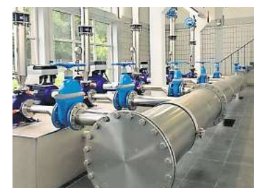
Die neuen Pumpen in der Pumpenhalle. FOTO: PRIVAT
