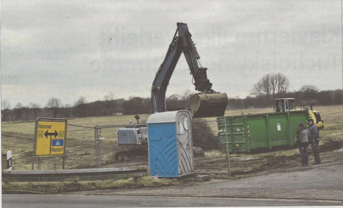
Um die Zuwegung für den geplanten Mineralstoffhandel zu schaffen, muss eine Wasserleitung mit einem Rohr geschützt werden.
