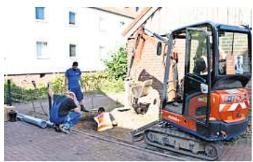
Rohrbruch am Fledermausweg: Mitarbeiter des Wasserverbands schauen sich den Schaden an. FOTO: GERKO NAUMANN
