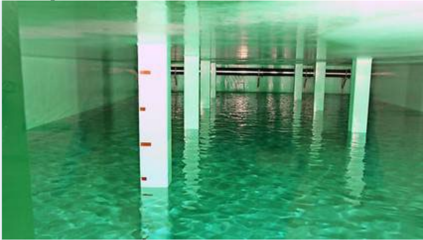
Der Pegel sinkt: So sieht der Speicherbehälter im Wasserwerk Hagen aus.
