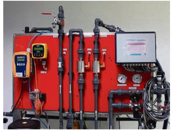
Der Wasserverband Garbsen-Neustadt (WVGN) beendet den 9-monatigen Probetrieb der Pilotanlage zur Nitratentfernung im Wasserwerk Hagen. Foto: WVGN
